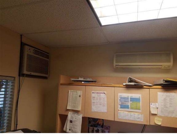
PTAC and Mini Split Indoor Unit
