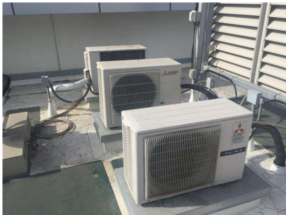
Mini Split System Heat Pumps
