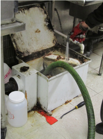
Vệ sinh thiết bị chặn mỡ nhà hàng. Hình chụp: Quận San Diego
