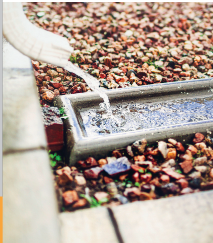
Ông dẫn nước mưa và bộ phận chặn nước bẩn
