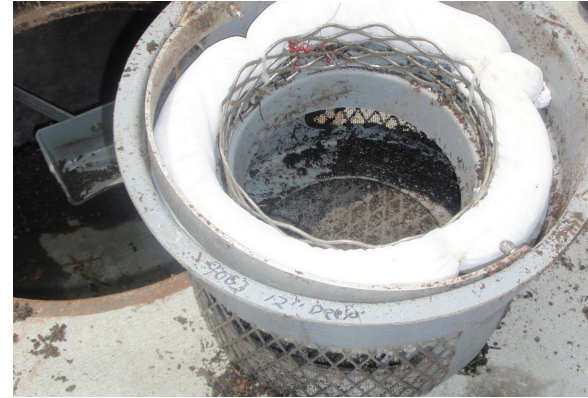
BMP Chắn Rác
